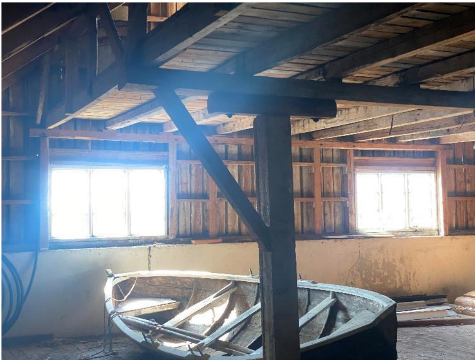
Fra tredje etasje sett mot sør. Stolper og bjelkelag i tre. Grovt bindingsverk i yttervegg satt på muren. En bru blir båret av trestolpene. Fra denne er dg utgang/inngang i gavlen i nord.
